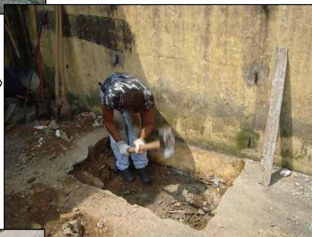
Trabalhos de remoção do piso original do Galpão 1 identificado no nível 5 da S.24.
