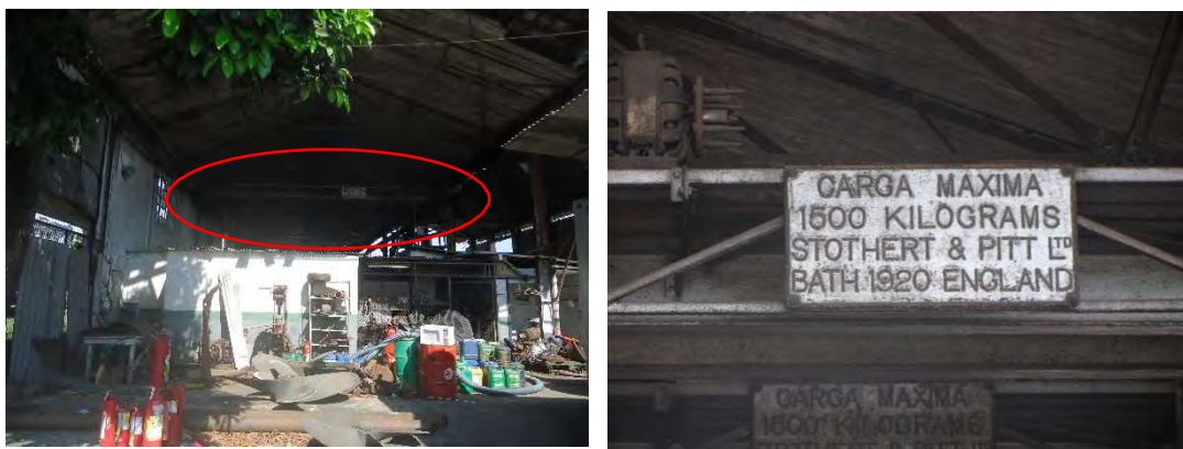
Figura 11 - Ponte rolante existente no Armazém 4
