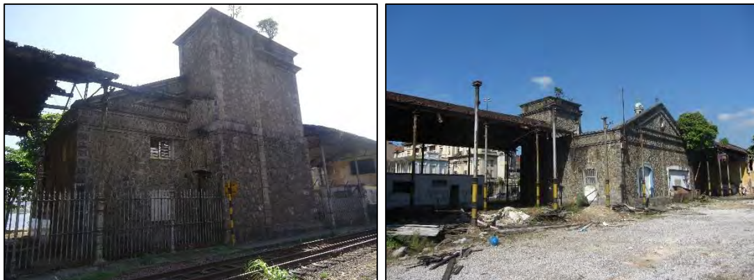
Figura 7 - Aspecto atual da casa de máquinas compressoras existente entre os armazéns 3 e 4
