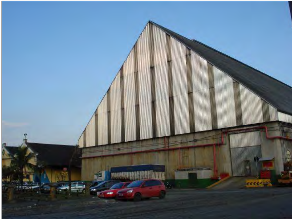
Foto 7: Galpão com estrutura diversa da concepção do conjunto
