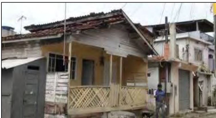
Única casa de tipologia caiçara identificada em Santa Cruz dos Navegantes, encontrando-se em mau estado de conservação.
